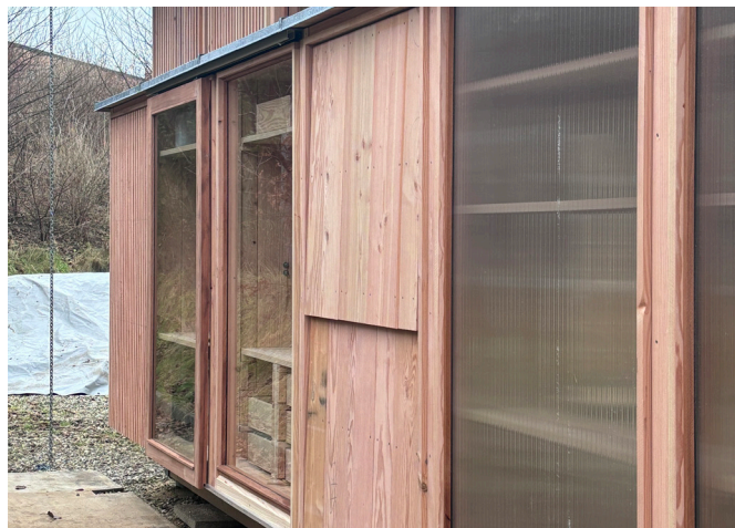
Foto fra eksempelbyggeri. Facadeelementer fra Udestuen, Værkstedet og Naturbasen.
